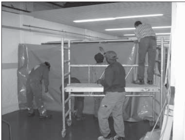
Tijdens de verbouwingen voor ons winkelpunt in Lier werden milieuvriendelijke gipsplaten gebruikt en natuurverf.
